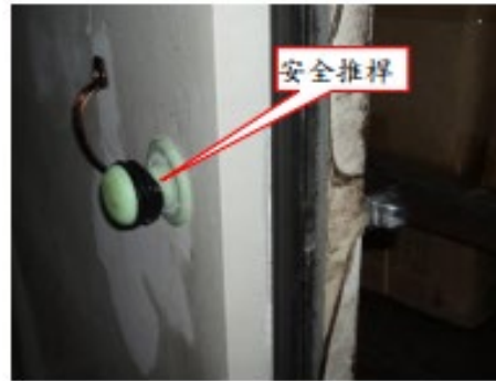
原料冷凍庫出入口之門內側設安全推桿
